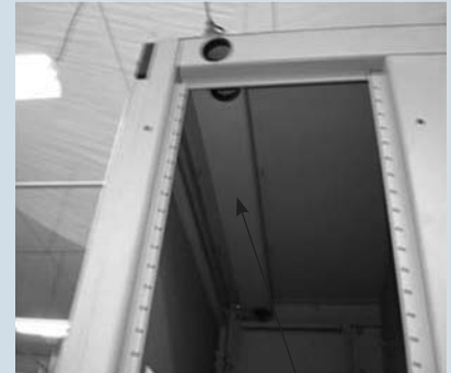
Canales de alambrado
